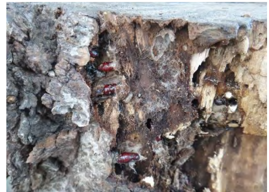
図7 腐朽箇所を剥がすと蛹(赤褐色)が見つかった
