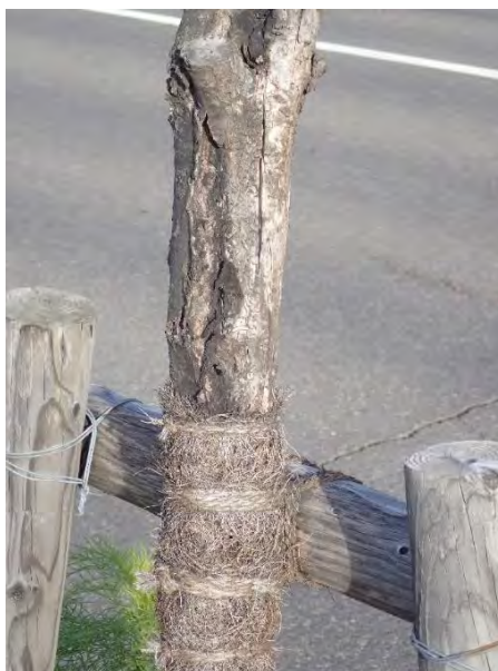
日焼けによる脱落、凹み
