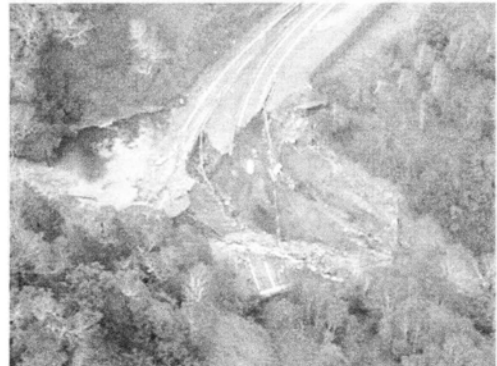
R274号日勝峠 清水町8号目付近（室蘭開建撮影）
