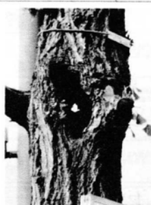
写真Ⅲ-2-7 幹の開口空洞
