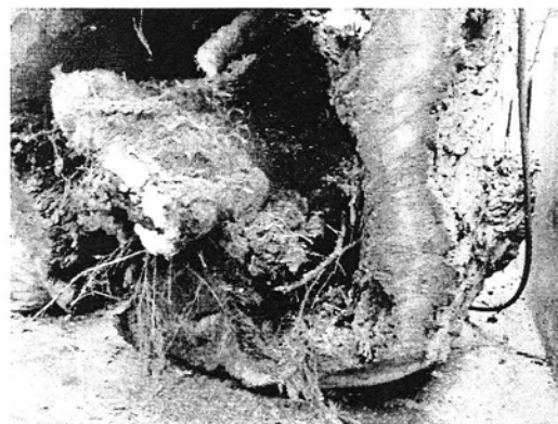
写真 5 レジストグラフ試験(4方向)では確認されなかった柱(板根)状の不定根。H22.11.09
