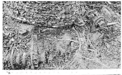
写真-3 食い込むベルトとアンカーの金具
