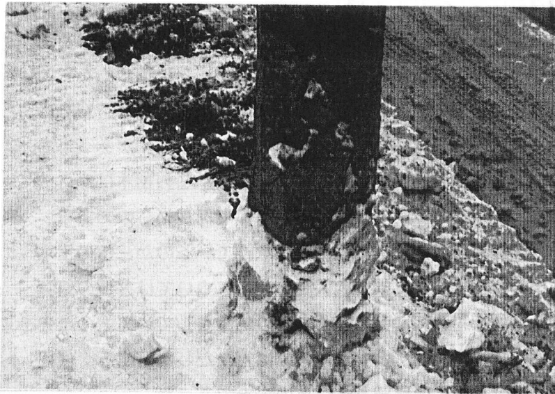
写真-3 根本に新たな傷と上には古傷が多い
